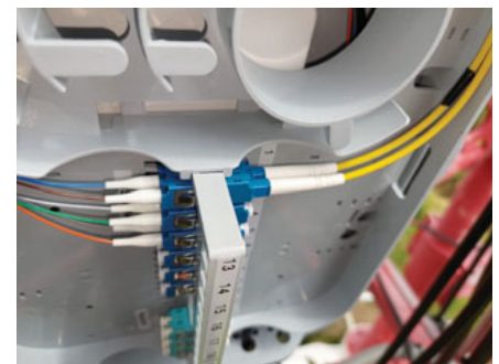
rechts: LWL-Verteiler am Mast
