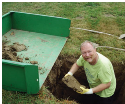
Ein Loch wird gegraben. OE6FNG bei Erdarbeiten für das Fundament der EME-Antennen und rechts mit OE6GBG Gerald beim Einrichten der Schalung.
