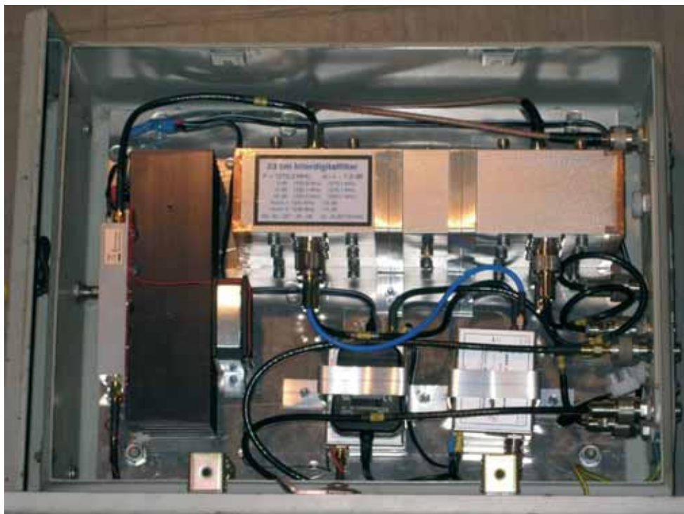
Innenansicht der Mastseinheit
